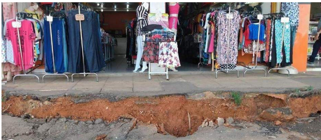
Figura 5. Cidade Rachada. Rua com asfalto rachado pela enchente do rio Acre.
